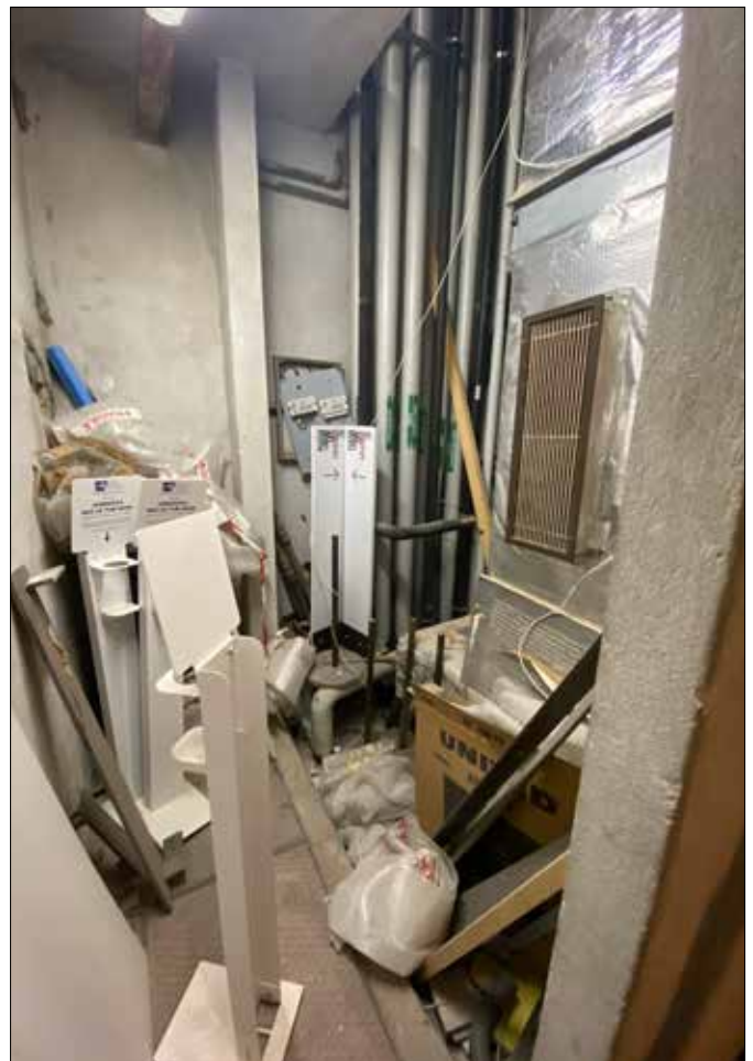
Vano tecnico primo piano
