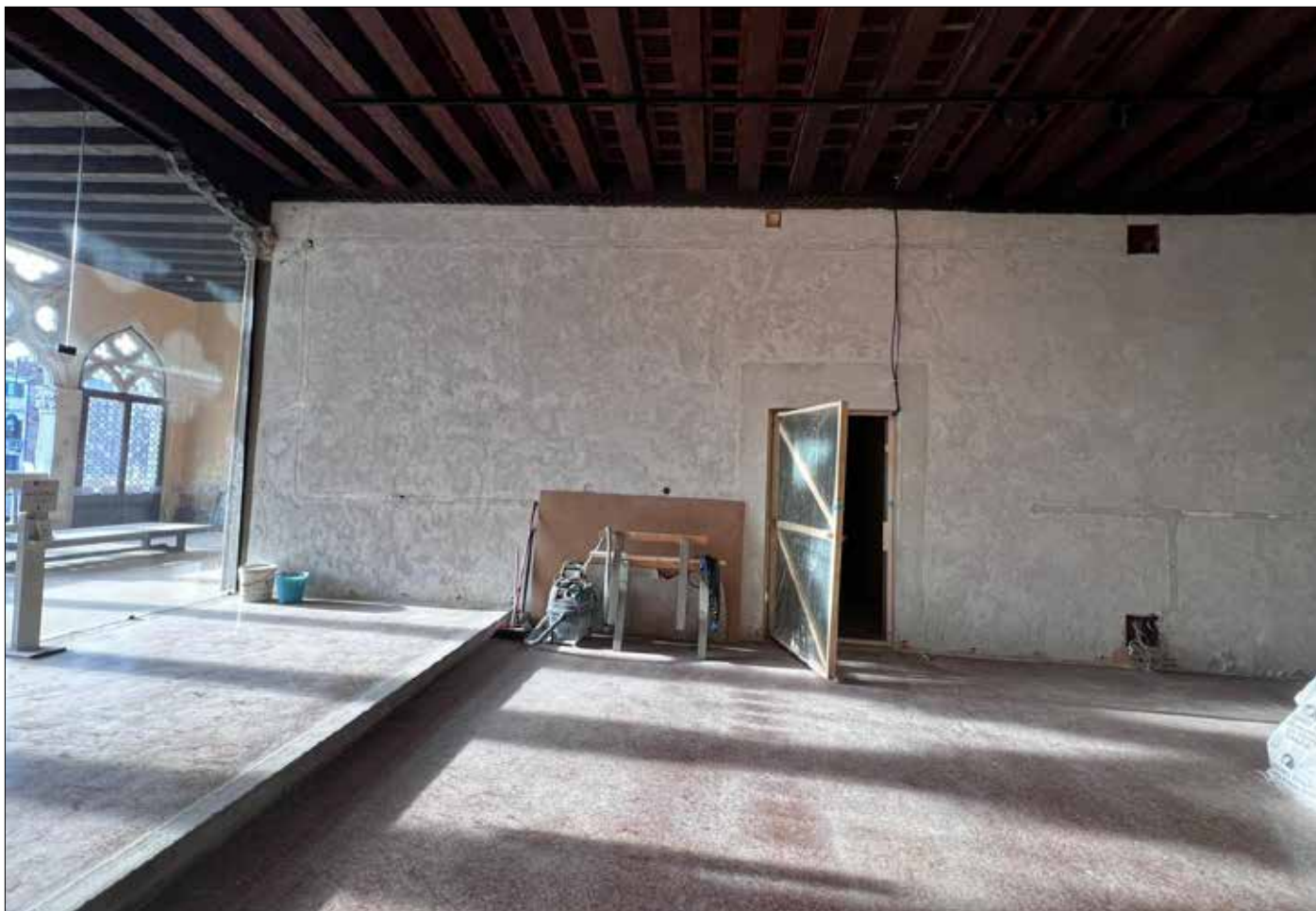
Foto cantiere con faretto su binario
