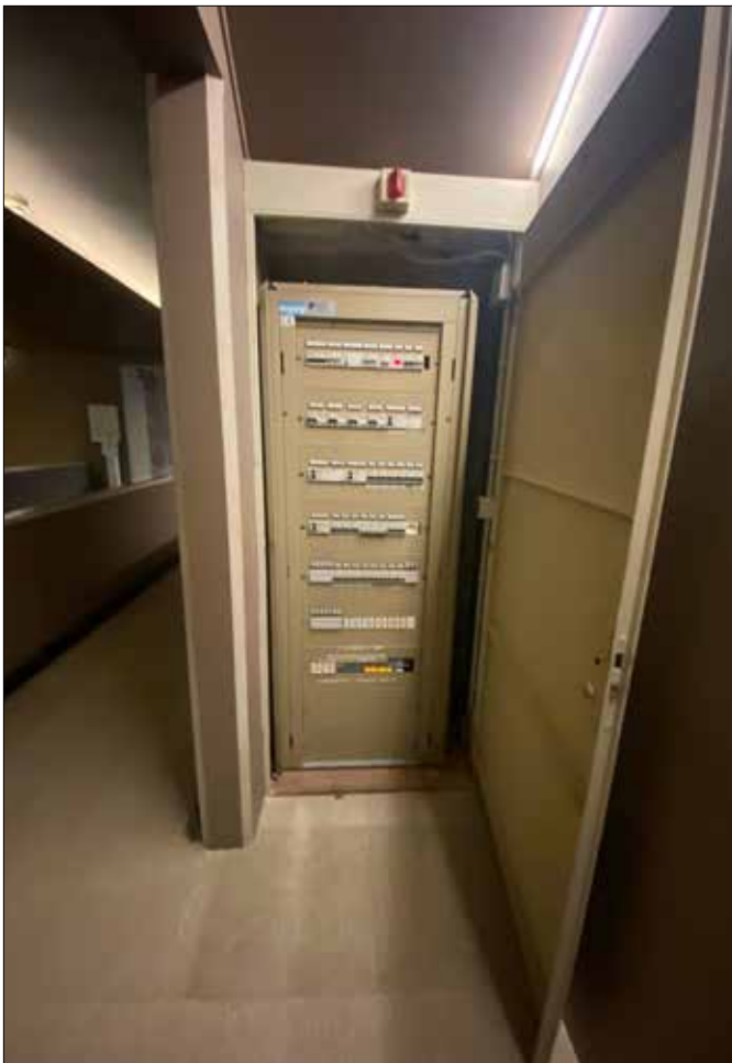
Vano tecnico primo piano fronte ascensore con rilevatore ottico di fumo e segnalatore ottico
