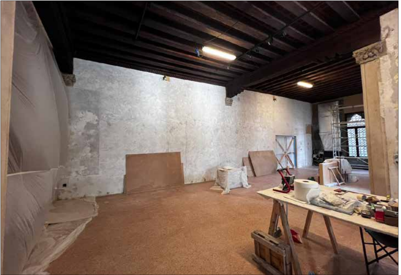
Foto cantiere con faretto su binario
