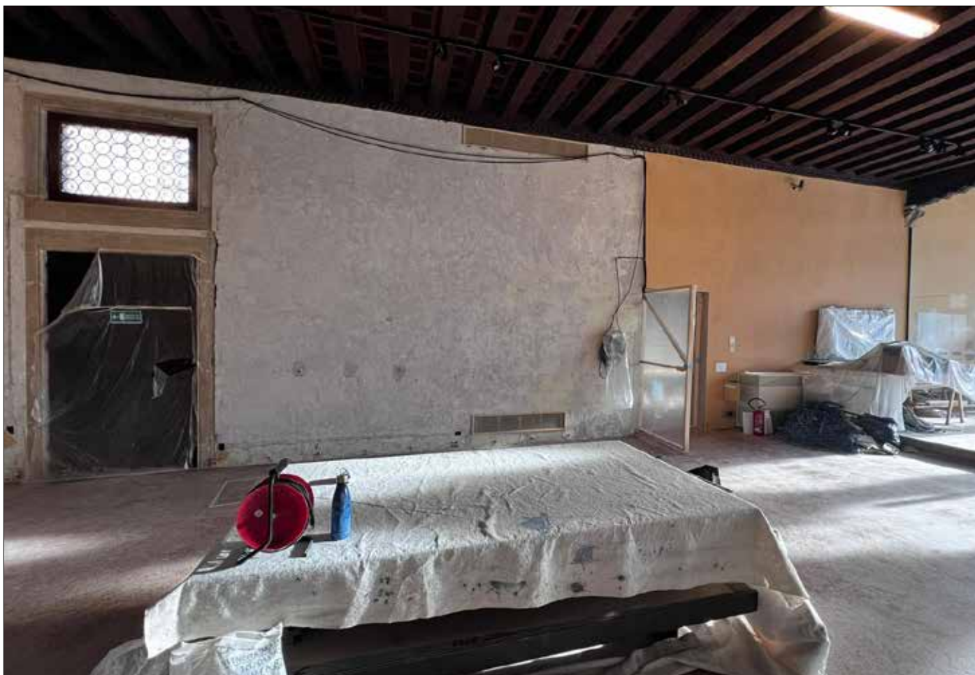
Foto cantiere con faretto su binario
