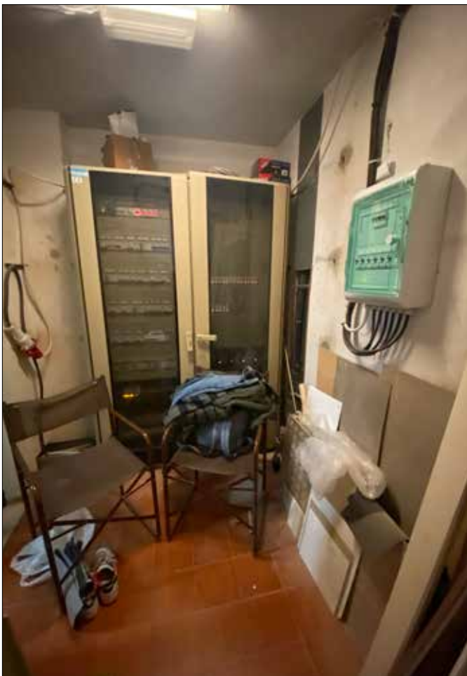
Vano tecnico primo piano
