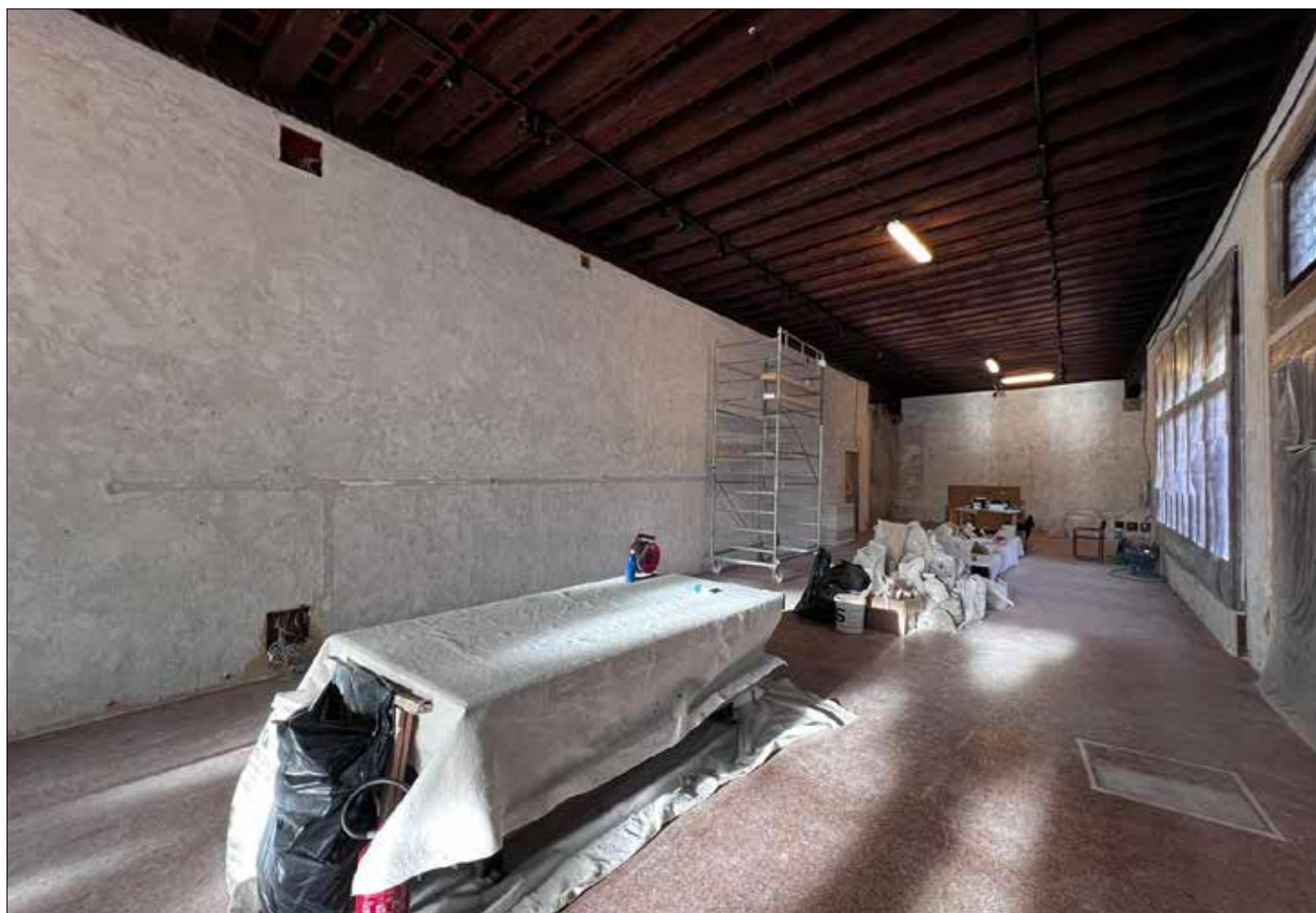
Foto cantiere con faretti su binario
