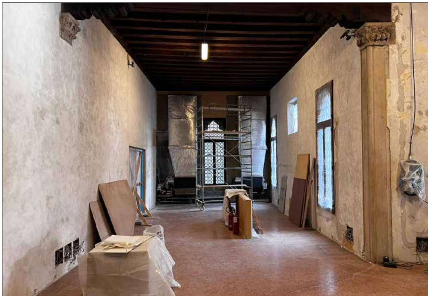
Foto cantiere con faretti su binario
