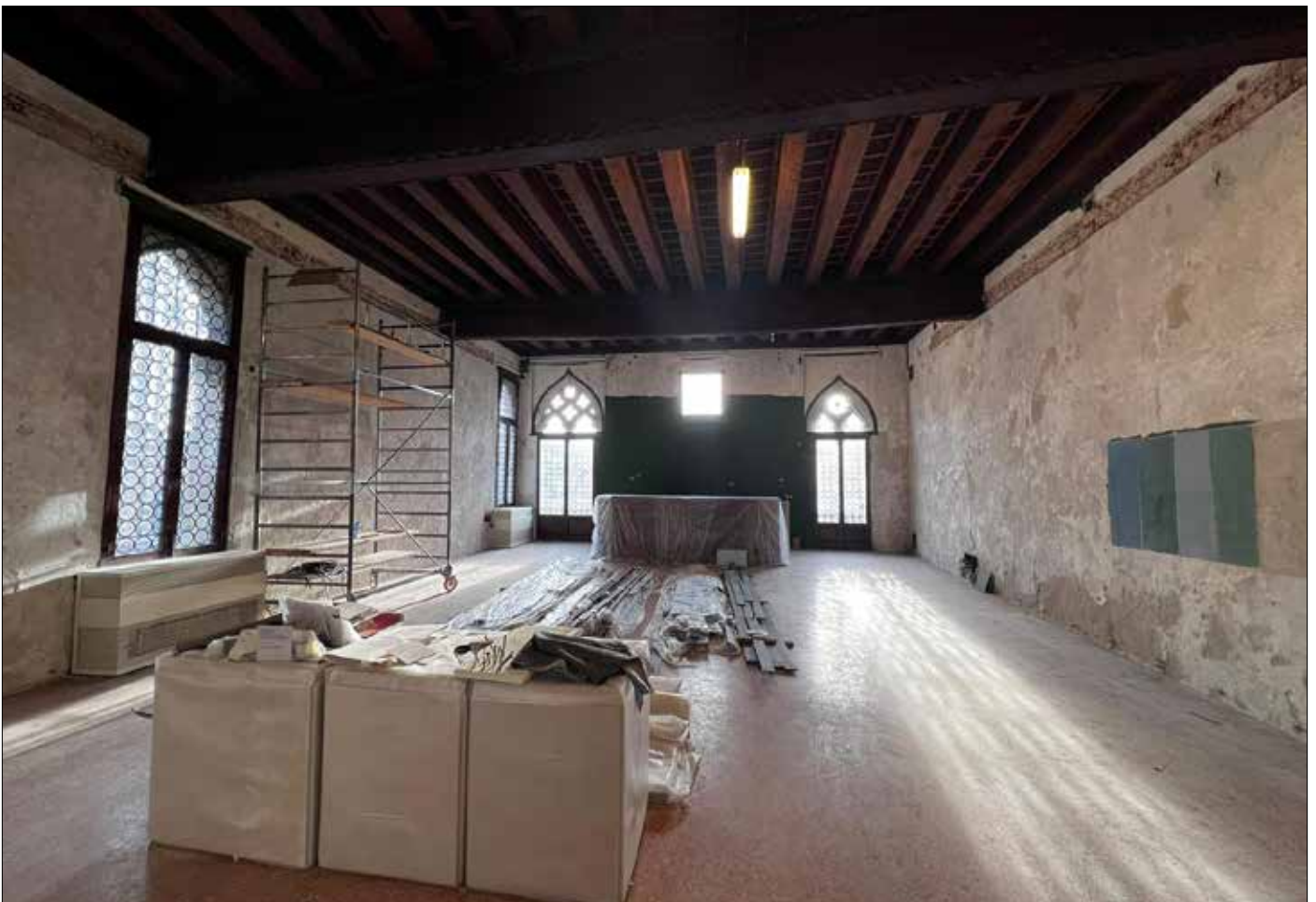
Foto cantiere con faretto su binario
