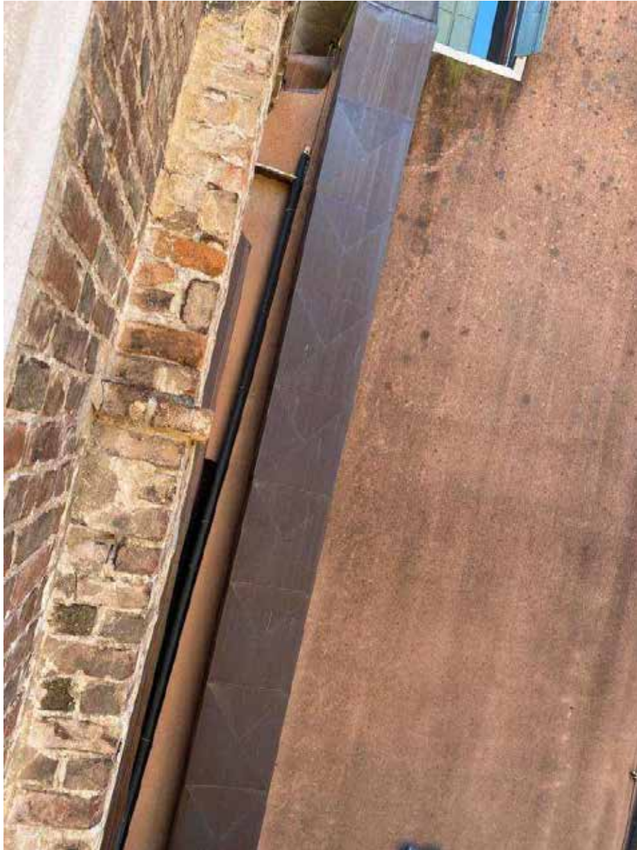
Cavedio di installazione condotta dell'acqua
