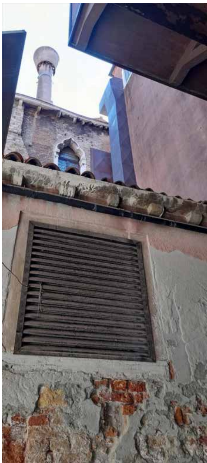
Cavedio di installazione condotta dell'acqua
